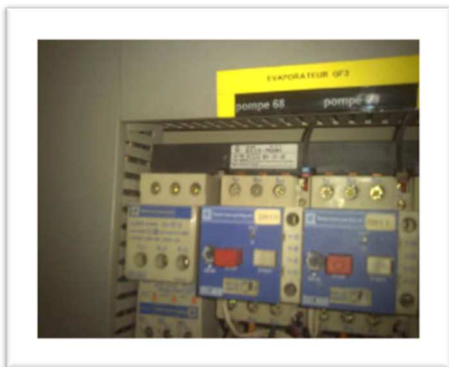
Contrôle électrique de maintenance
